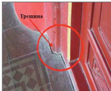
Рис. 2. Одна из трещин, обнаруженных внутри Колокольной башни
