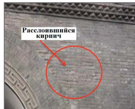
Рис. 3. Один из расслоившихся кирпичей, обнаруженных в цоколе Колокольной башни
