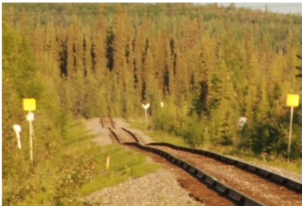
Рис. 11. Деформация полотна Аляскинской железной дороги при таянии подземных льдов [3]
