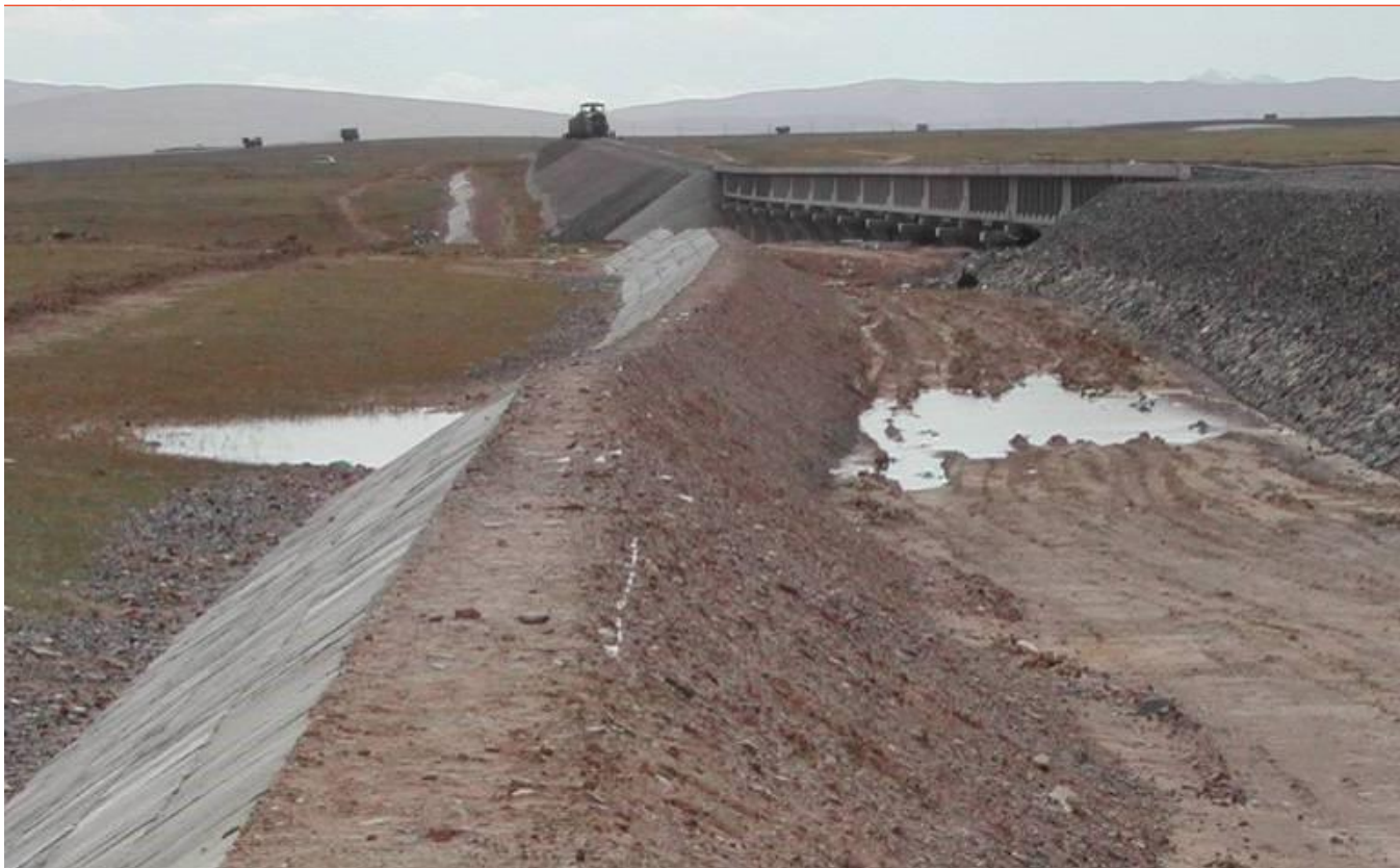
Рис. 13. Деформация полотна железной дороги Цинхай-Тибет на начальной стадии создания [8]
