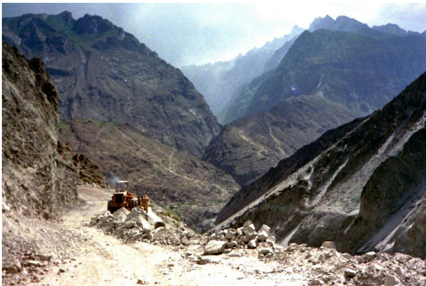
Рис. 5. Очистка Каракорумского шоссе после оползня 1985 г. [4]
