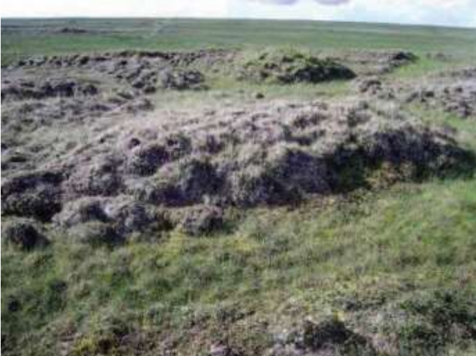
Рис. 2. Участок мелкого заложения и выдавливание трубы на поверхность в средней части трассы. Фото из [14]
