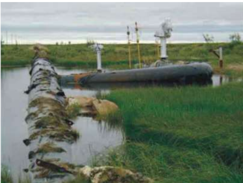
Рис. 1. Всплытие трубы на замаренном участке трассы [14]
