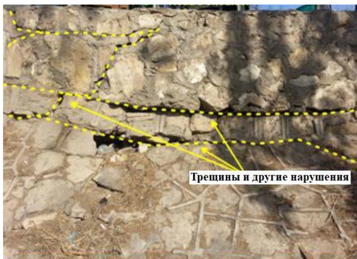
Рис. 4. Трещины и другие нарушения в боковой части выходного оголовка водопропускного сооружения в примере 1 [2]
